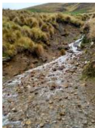
Imagen 2. Una de las vertientes de agua sobre la vía.
